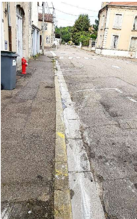
État de la chaussée rue des Ecoles
